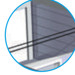
Soğutucu akışkan boruları
